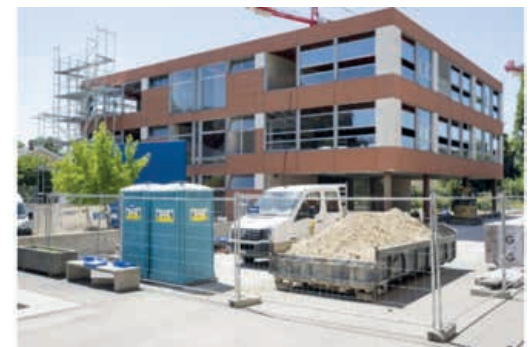
Le collège des Tertres en travaux. Sa consommation d'énergie de chauffage a été réduite d'un facteur 4 et l'installation solaire photovoltaïque posée en toiture produira chaque année deux fois plus d'électricité que le collège n'en consommera
