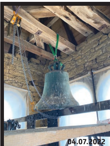
Le beffroi en acier, endommagé par la corrosion, a été démonté. Les trois cloches, datant des années 1766, 1843 et 1859, sont suspendues à la charpente en attendant le nouveau beffroi.
